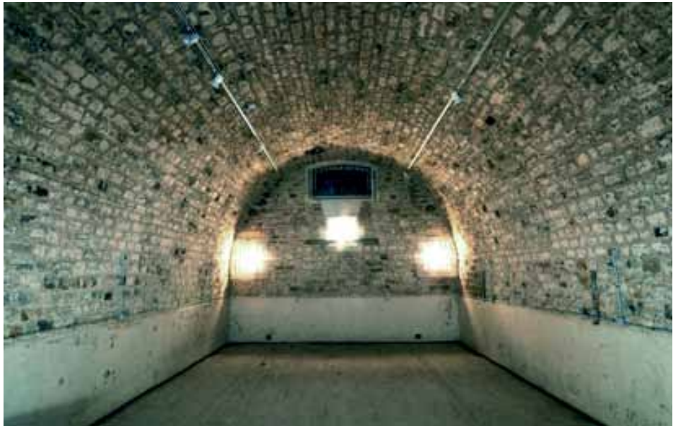
Vue d'une poudrière. Au fond, on observe les ouvertures donnant sur la chambre des lampes.
